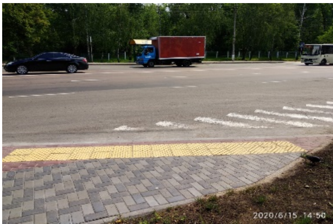
Рис. 1.11. Невірне укладення тактильної плитки: дезорієнтація напрямку руху, невірне місце розташування, місто Полтава
