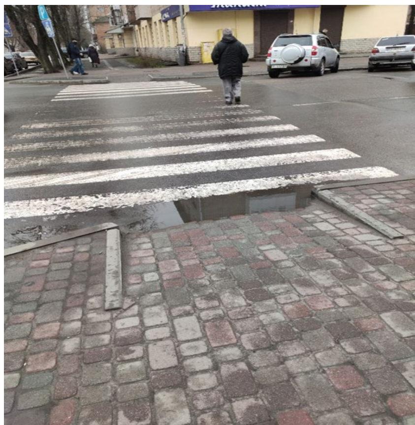
Рис. 1.8. Неправильне виконання вертикального планування призводить до накопичення води, руйнування покриття та неможливості користуватися територією, м. Полтава
