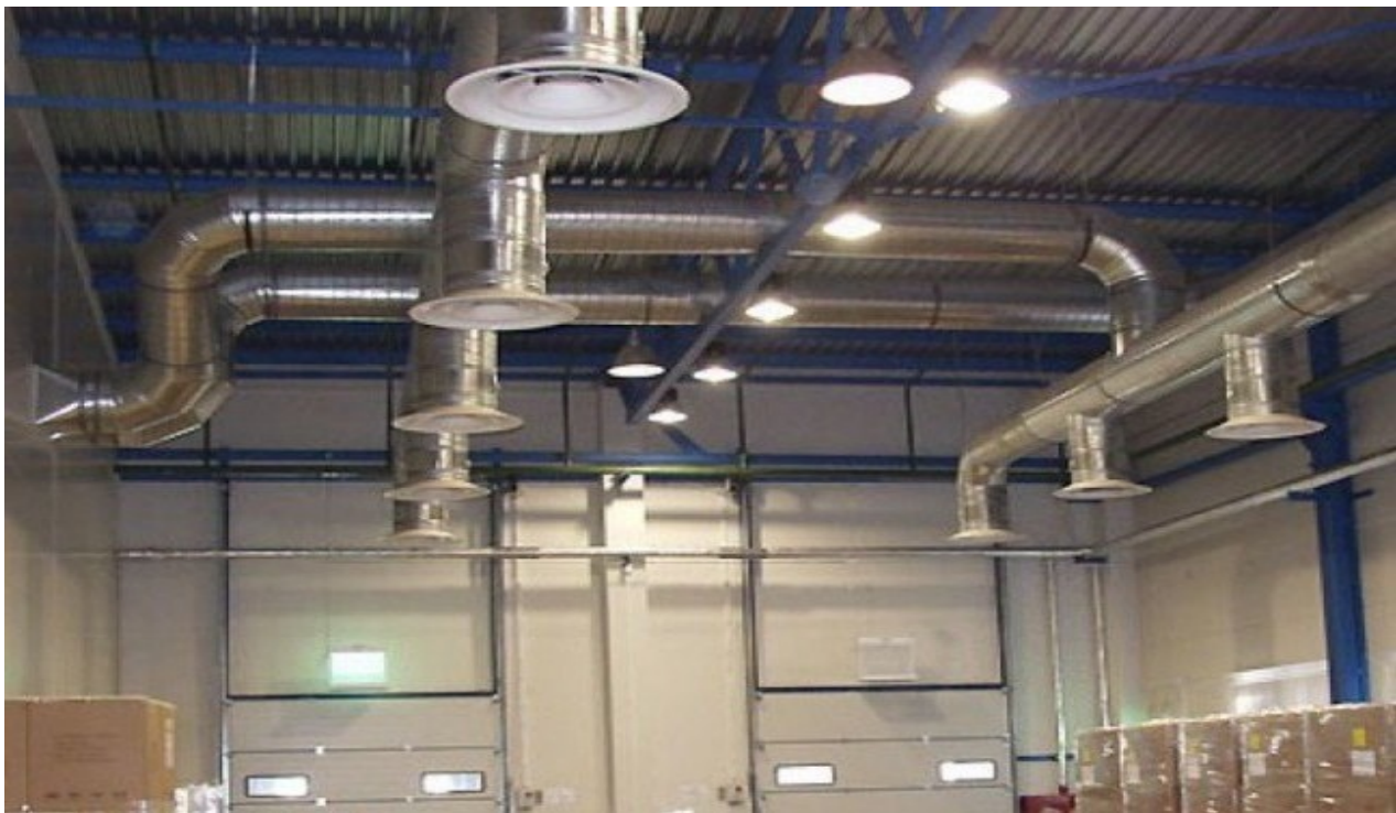
Загальнообмінна вентиляція цеху
