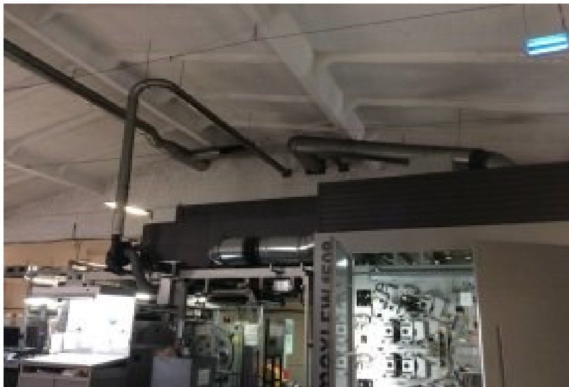
Витяжна вентиляція в цеху
