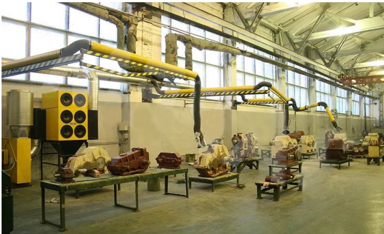
Вентиляція фарбувального цеху
