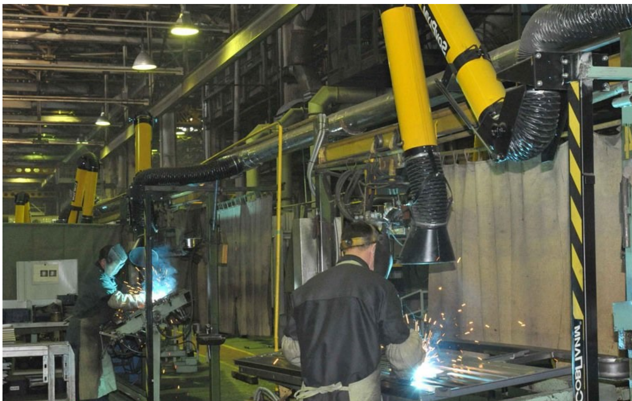
Вентиляція зварювального цеху
