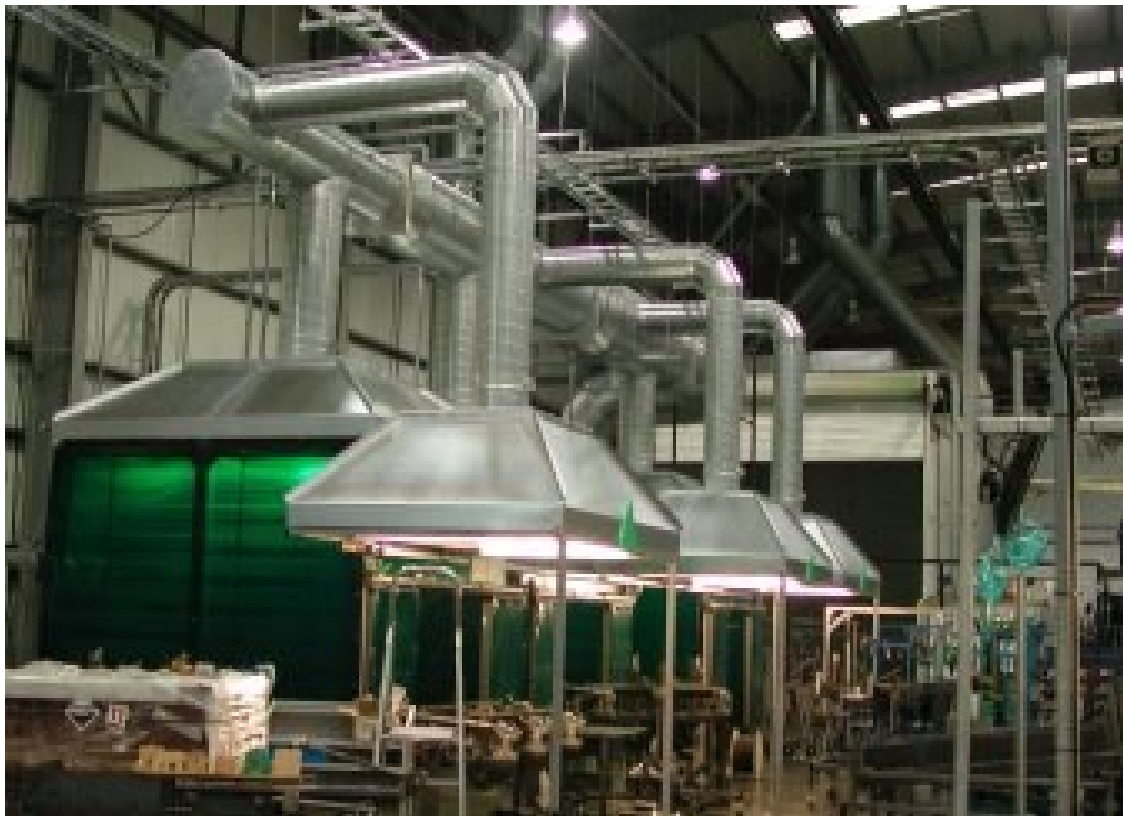
Вентиляція у промисловому цеху
