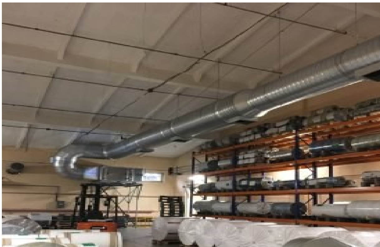
Припливна вентиляція в цеху
