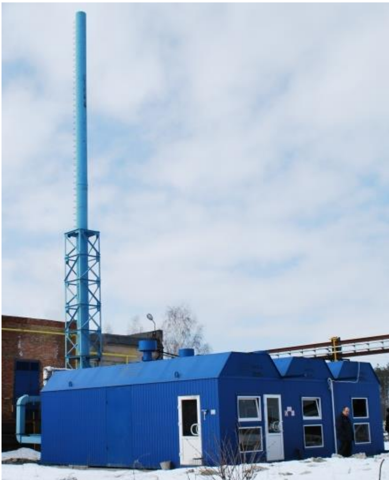
Рисунок 45 – Вигляд модульної котельні
