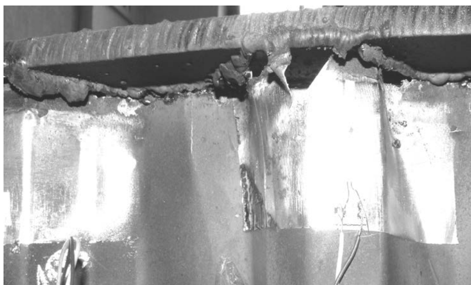
Рис. 3. Зона руйнування стінки балки біля поясного шва
