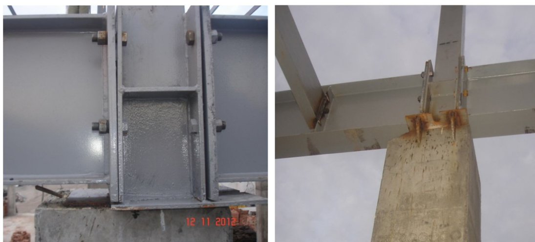
Рис.1. Дефекти монтажу внаслідок неякісних вихідних даних
